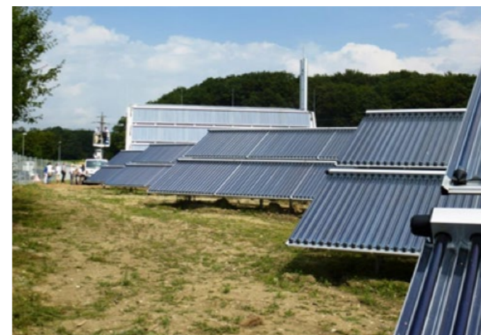
图38：布辛根（Büdingen）集热站的真空管集热器
