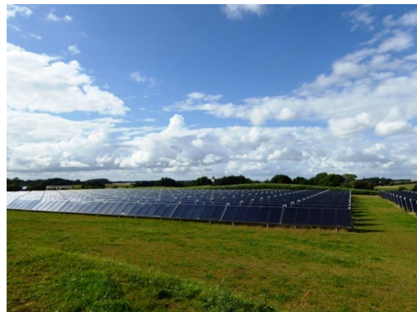
图40：多宁隆德（Dronninglund）附近集热站的平板集热器
