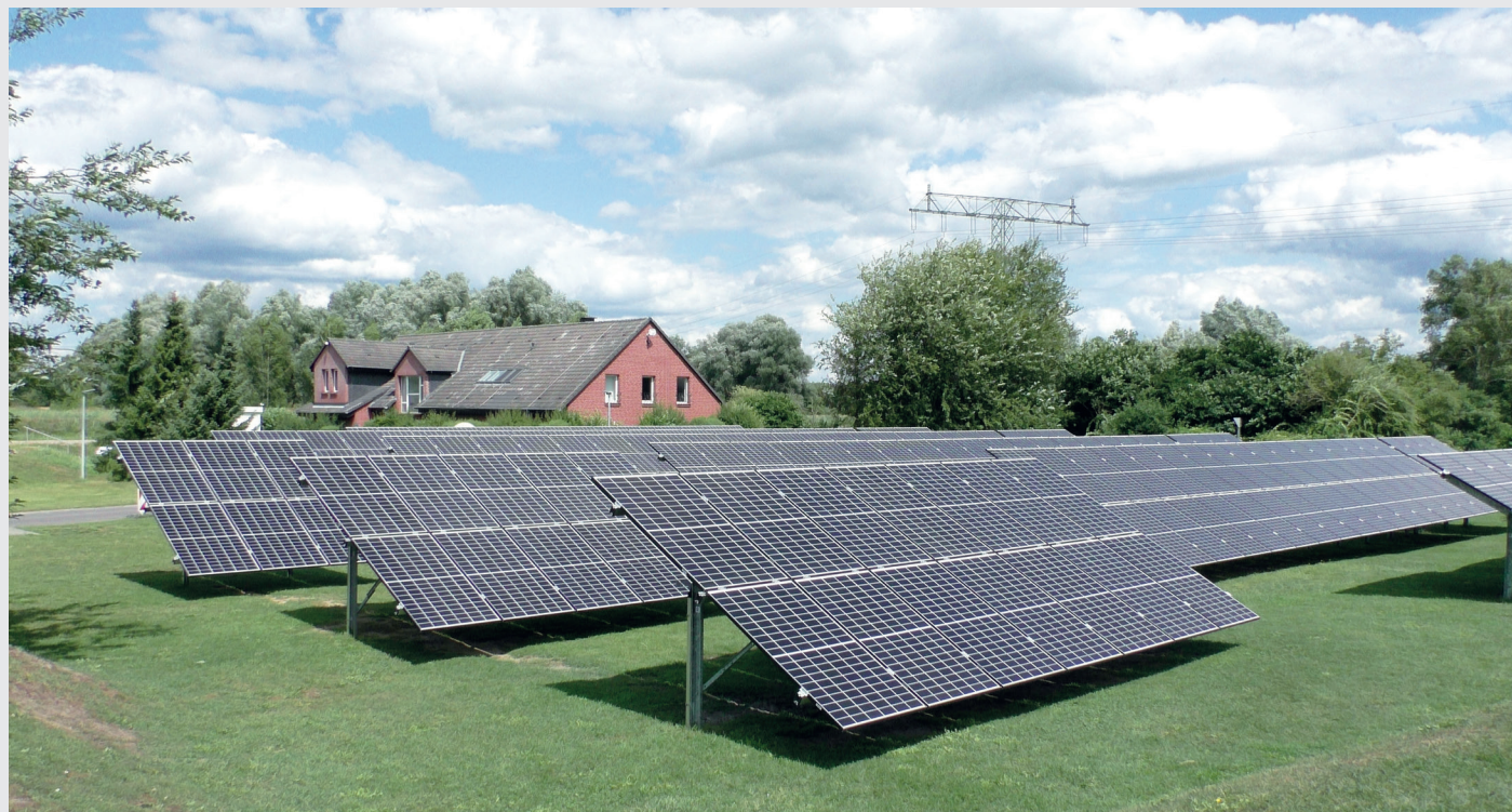
Bild 1 Die 100-kWp-Freiflächen-Photovoltaikanlage mit einem Batteriespeicher deckt ein Drittel des Stromverbrauchs der Kläranlage Liebenwalde (Brandenburg). Quelle: Aerzen
